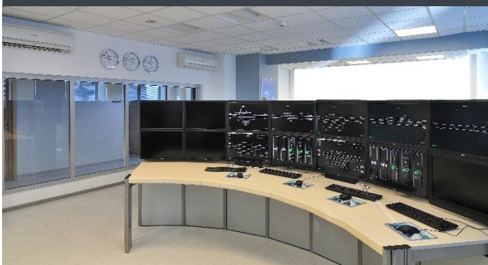
Lokalne Centrum Sterowania (LCS) w Katowicach
